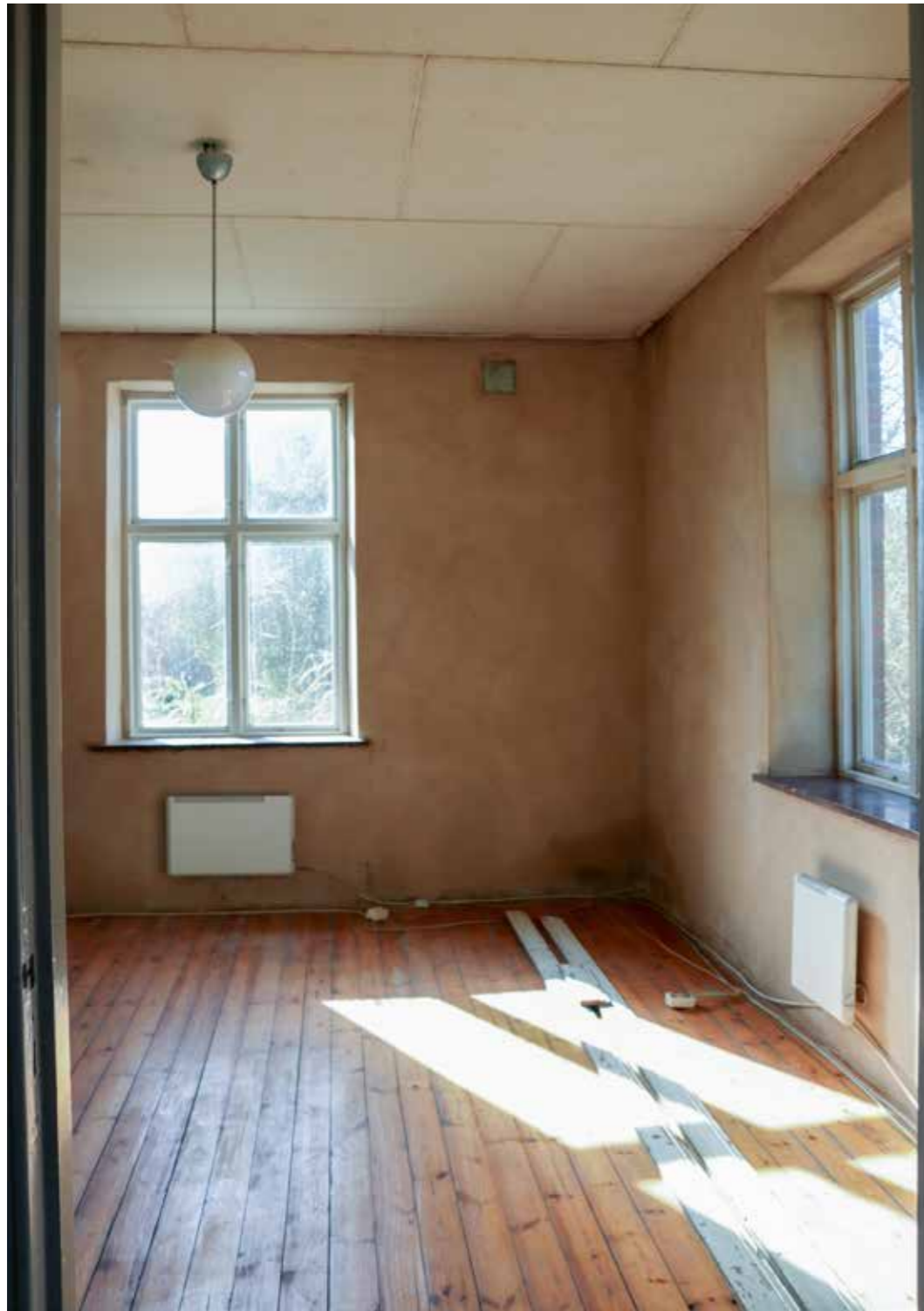
Västra sovrummet är omputsat med hydraliskt kalkbruk. Men de profilerade listerna hann inte komma på plats...
